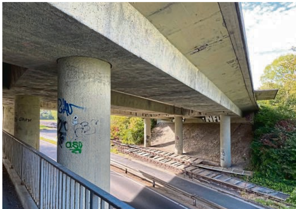
Die Brücke der L 3311 in Baunatal , nahe des VW-Werks Kassel, wird bis Ende des Jahres restauriert. In dieser Zeit wird Einschränkungen für Fußgänger und Autofahrer unterhalb der Brücke geben. FOTO: RAPHAEL DIGIACOMO
